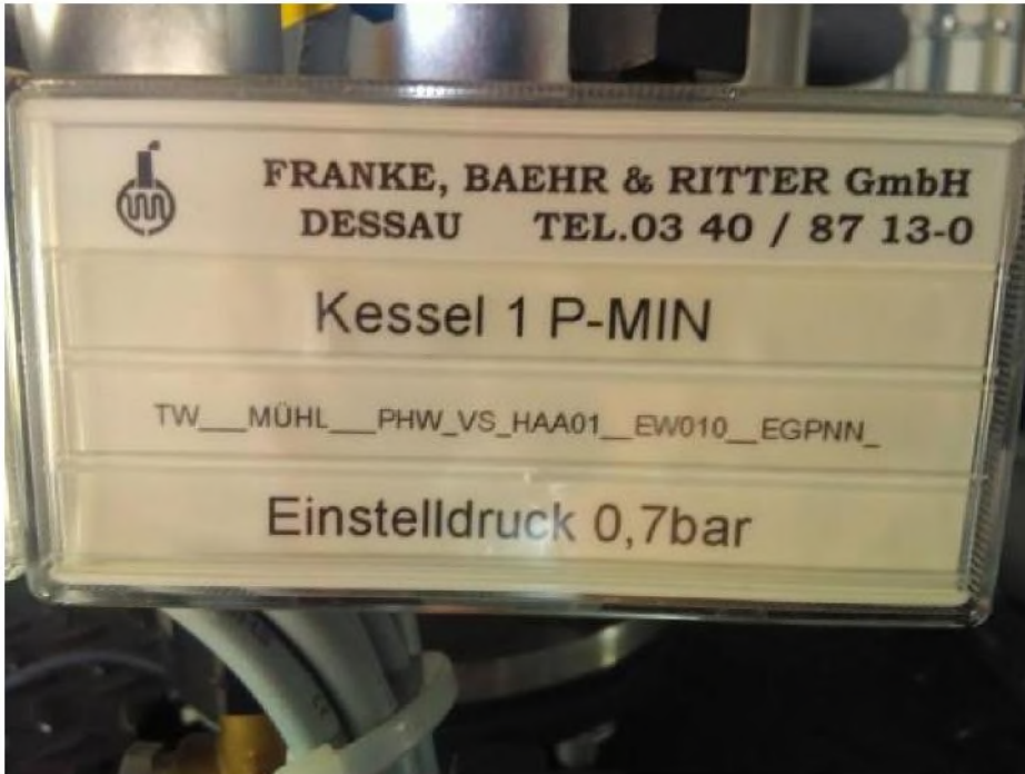
Sensorik, Schaltgeräte und Kabel
