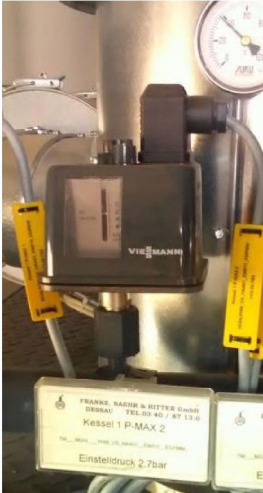
Sensorik, Schaltgeräte und Kabel
