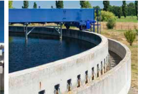
Im Nachklärbecken läuft das gereinigte Abwasser über Tauchrohre in die außenliegende Rinne.
