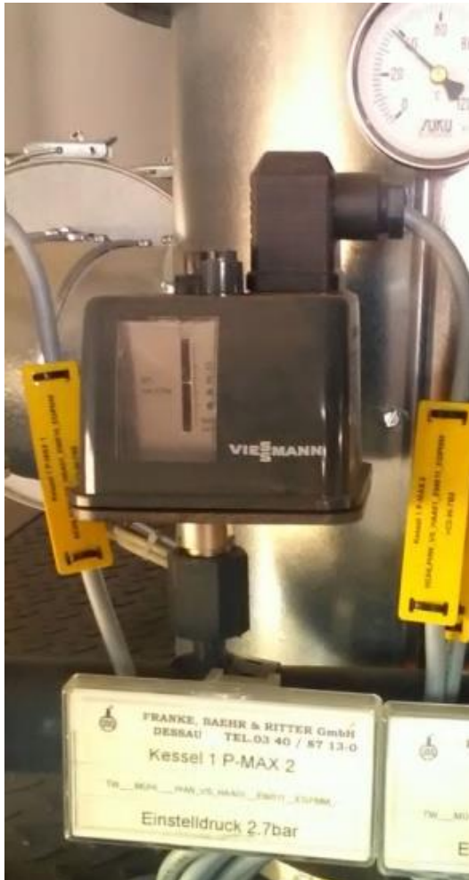
Sensorik, Schaltgeräte und Kabel
