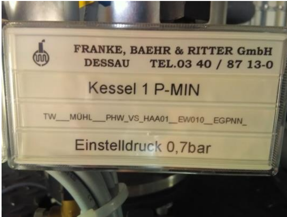
Sensorik, Schaltgeräte und Kabel
