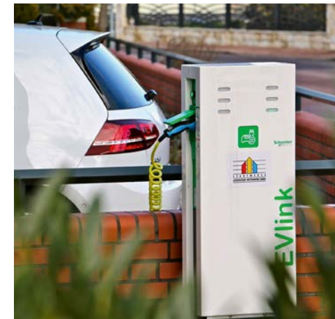
Für moderne Mobilität: 2014 nahmen die Stadtwerke die erste Ladesäule für Elektroautos in der Lucas-Cranach-Straße 22 in Betrieb.
