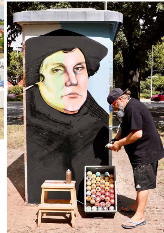
2020 ließen die Stadtwerke Gas-Druckregelanlagen von Graffiti-Künstlern gestalten.
