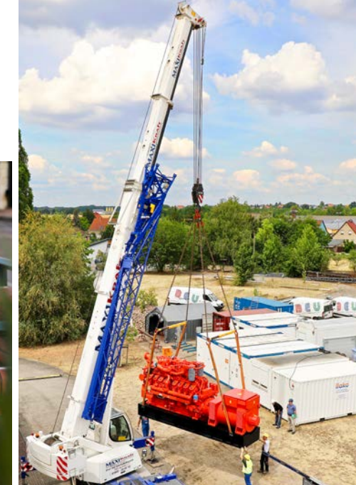
Für mehr Energieeffizienz: 2018 erhielt das Blockheizkraftwerk in der Berliner Straße vier neue leistungsstarke Motoren.
