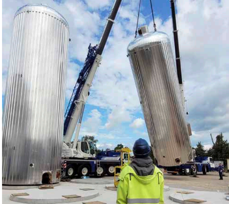
Kräne stellen die ersten beiden 100.000-Liter-Wärmespeicher am Standort BHKW Berliner Straße auf.
